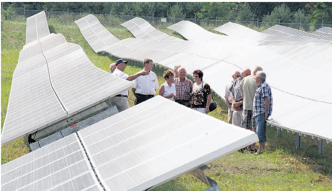
Mitgestalten. Einweihung eines Bürgersolarparks bei Stendal. Mit einer Kapazität von 13,6 Megawattpeak (MWp) soll die Anlage den Jahresstrombedarf von 3264 Haushalten decken. Bürger erwerben Anteile an ihrer Stromgewinnung auf ungenutzten Freiflächen. Foto: dpa
